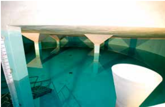
Trinkwasserbehälter Hagenbuchen des Zweckverbandes Wasserversorgung Unteres Schussental
