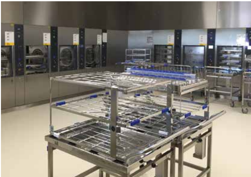
Reinigungs- und Desinfektionsgeräte (RDG), Projekt: Sanierung der Zentralsterilisation am Universitätsklinikum Düsseldorf
