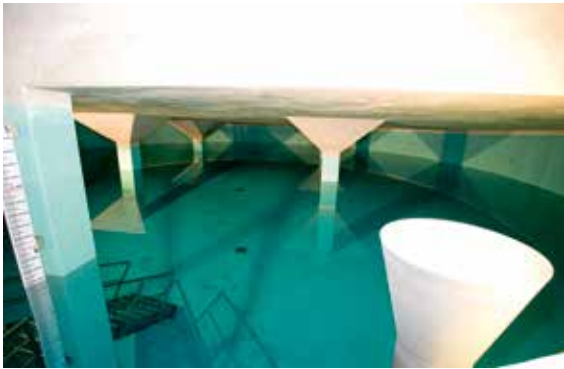
Trinkwasserbehälter Hagenbuchen des Zweckverbandes Wasserversorgung Unteres Schussental
